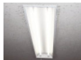
更新後の照明設備
