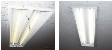
導入前の照明設備
