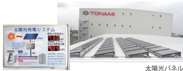
太陽光パネル
