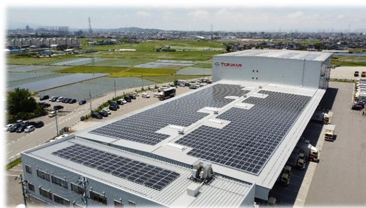
物流拠点の屋根に設置された太陽光発電
